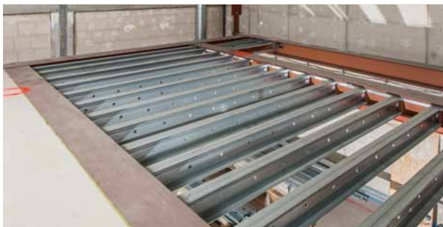
Schwerlastaufgabe. Im Centrolino in Oberhausen wurde das Knauf-Cocoon-System „Transformer“ erstmals als tragende Deckenkonstruktion eingebaut – mit 5 KN/m 2 Auftragslast.
